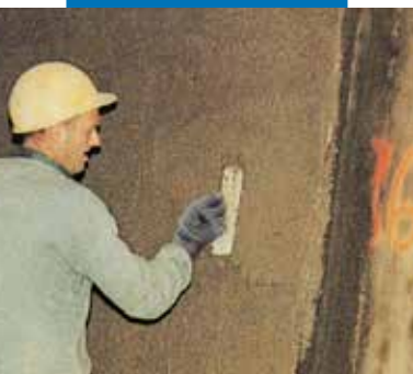
Tunel na autostradzie Ville Marie w Montrealu w Kanadzie. Nanoszenie tynku cementowego z dodatkiem Planicrete
